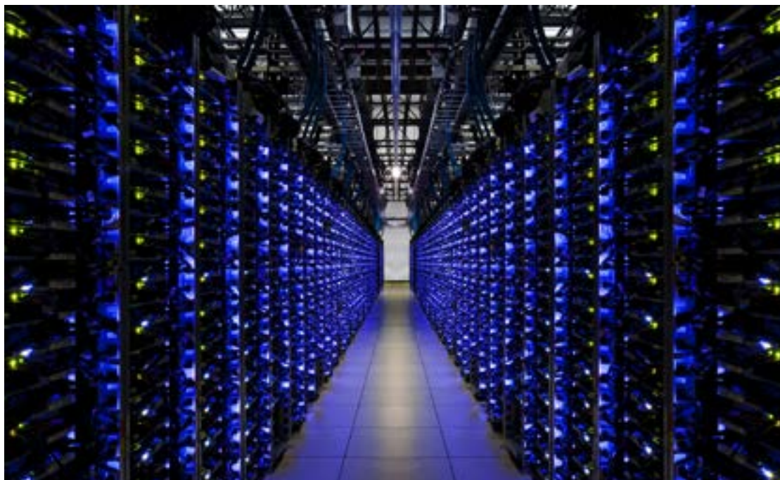
Fotografía del interior de un centro de datos de la compañía Google, Georgia (EE.UU.) Fuente: © Google Inc.
