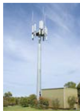
Estación base de telefonía móvil: caseta, torre y antenas.
